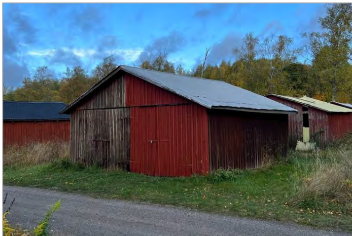
Garagen i den så kallade garagebyn är i stort behov av underhåll men de är välbevarade. Det delade ägandet har lett till olika ambitionsnivåer, ofta på ett och samma hus.
