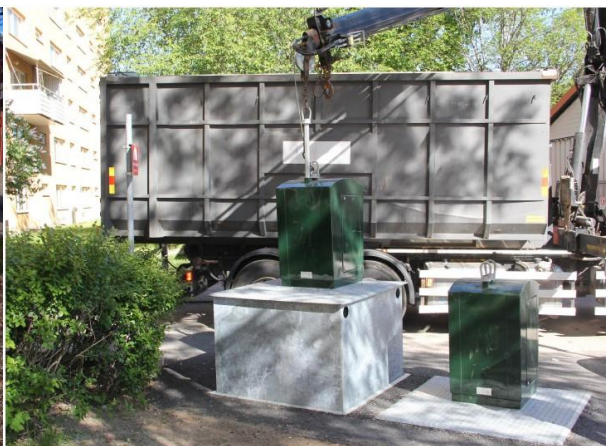
Figur 11 Hämtning av underjordsbehållare. Källa: Avfall Sverige.
