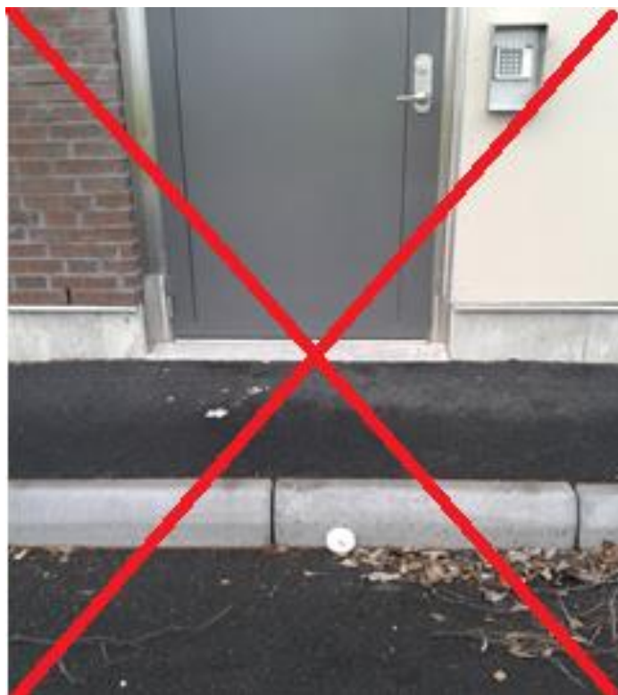
Figur 5 Bild på trottoarkant som inte ska förekomma.
