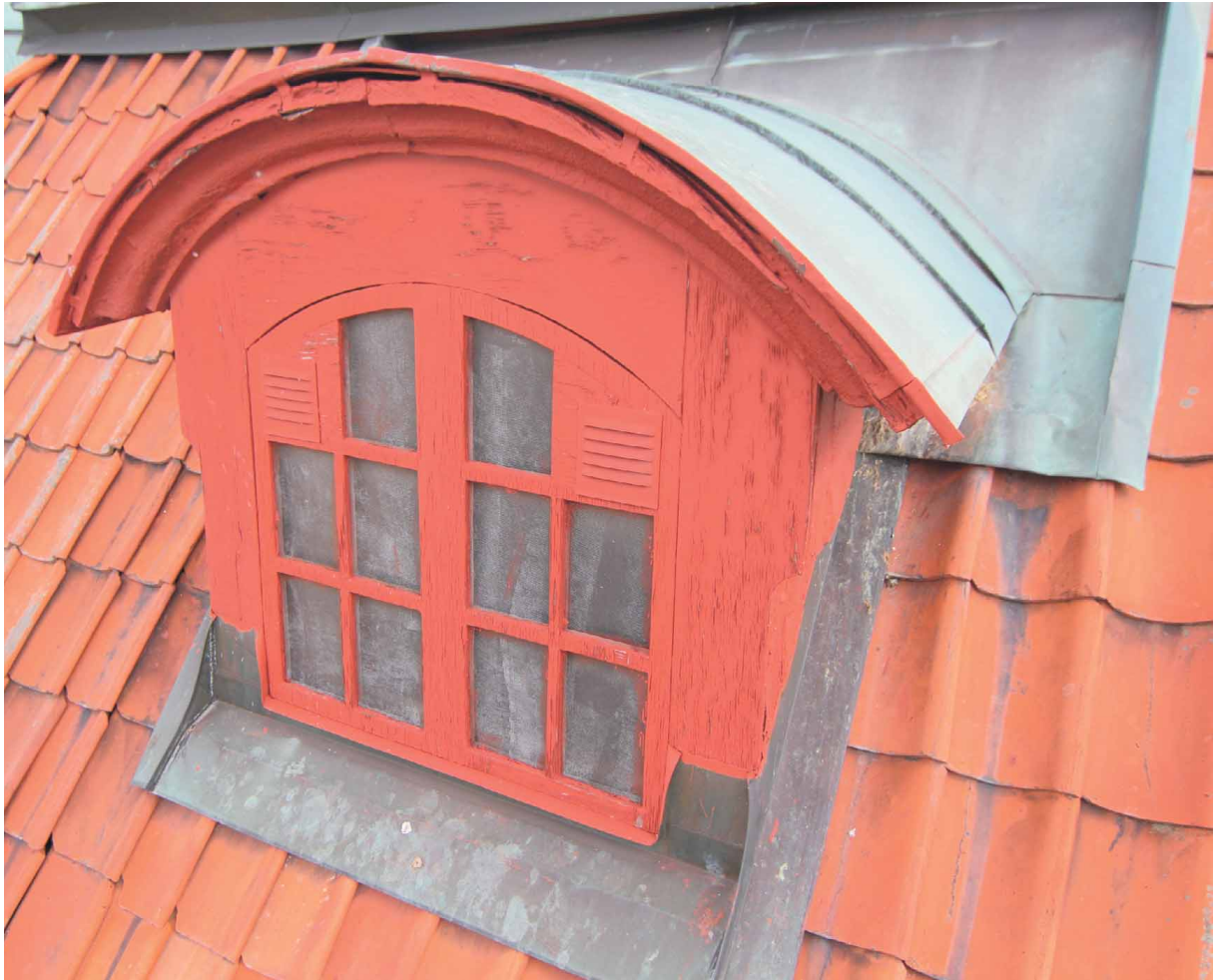
Takkupa mot väster med front och fönster i plywood.
