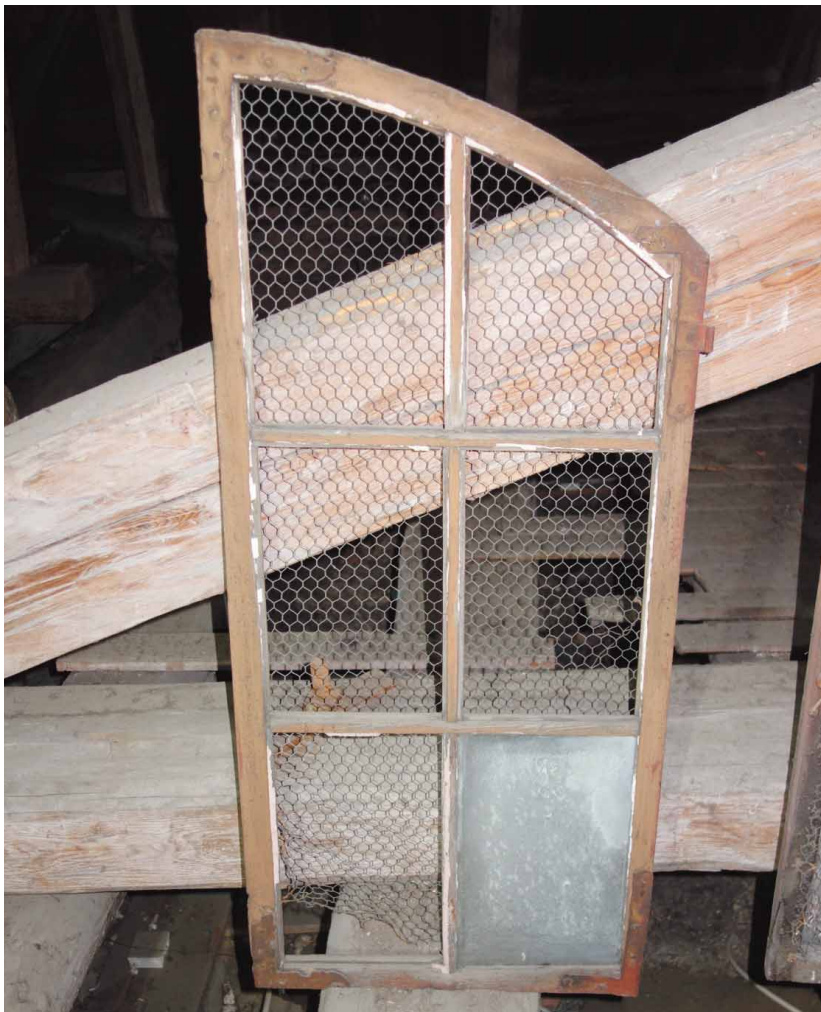
Äldre båge som finns förvarad på vind. Notera de smidda hörnjärnen på bågens vänstra sida.
