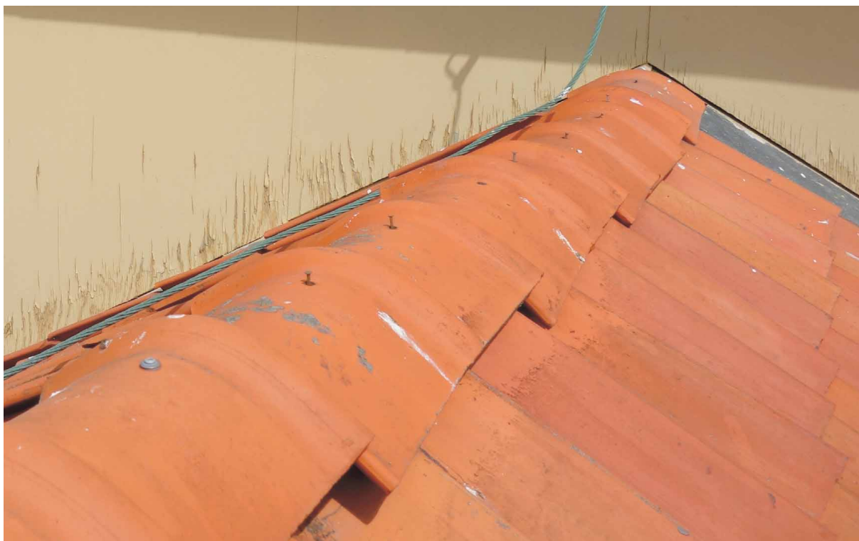
Felaktiga nockpannor där spikarna vandrat upp. Pannorna ligger löst och utgör en säkerhetsrisk.
