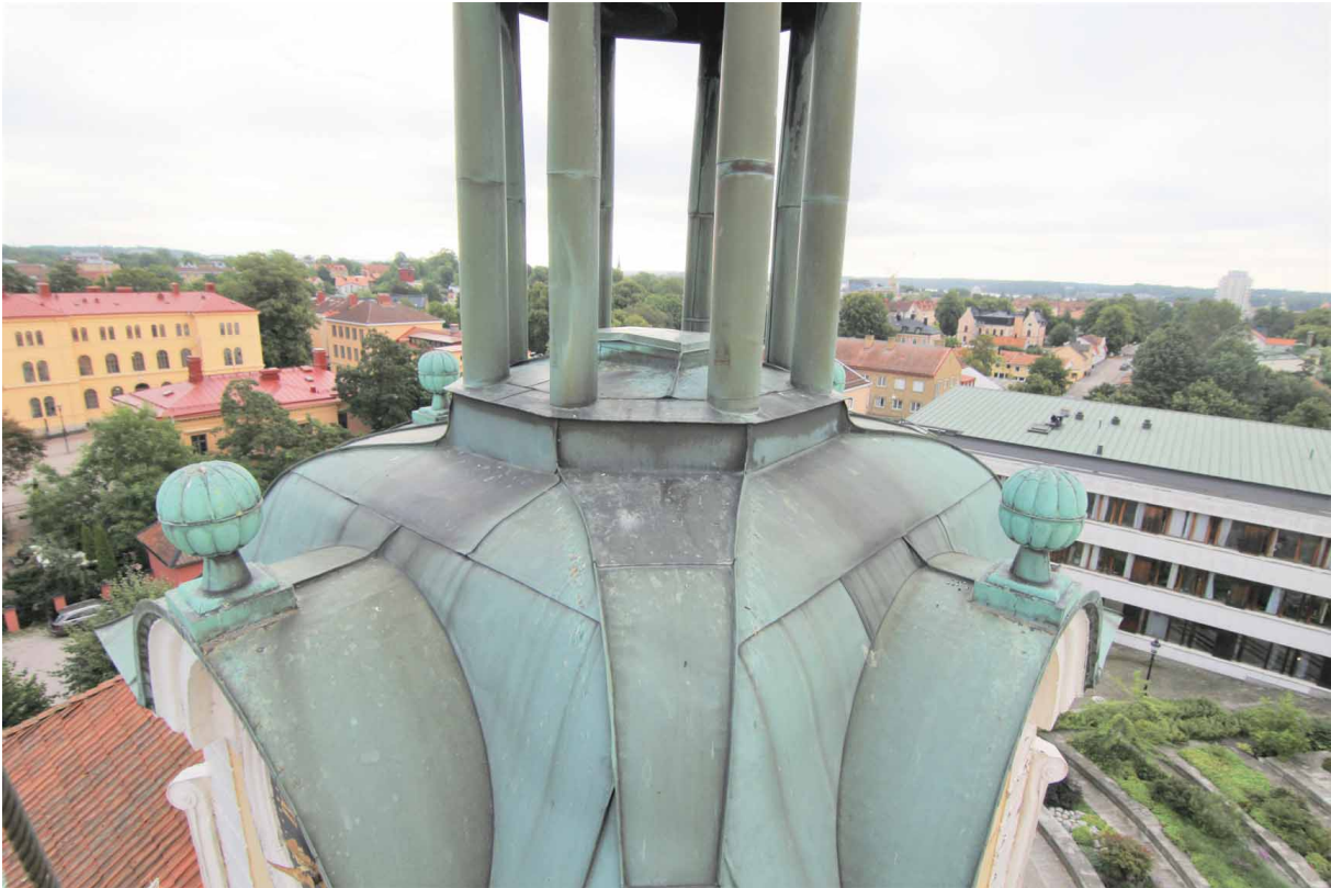
Tornbuv med klotformade ornament som ska stagas upp. Ovan tornbuven står de bärande pelarna vars skick inte kunnat utredas.
