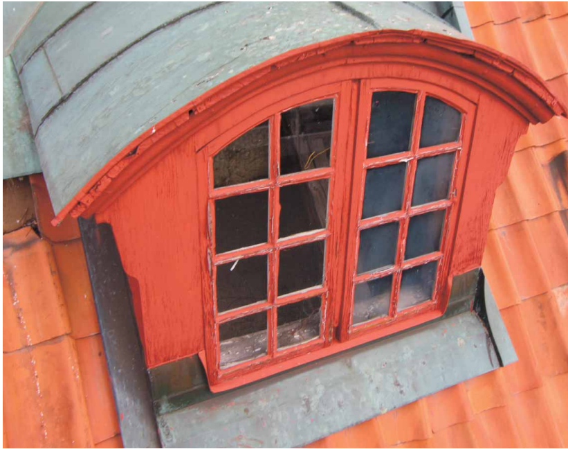
Takkupa mot söder med sentida fönster i dåligt skick.
