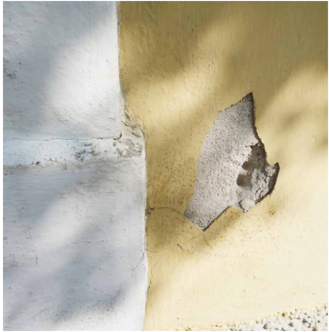
Skada i puts och slitet färgskikt på pilaster.
