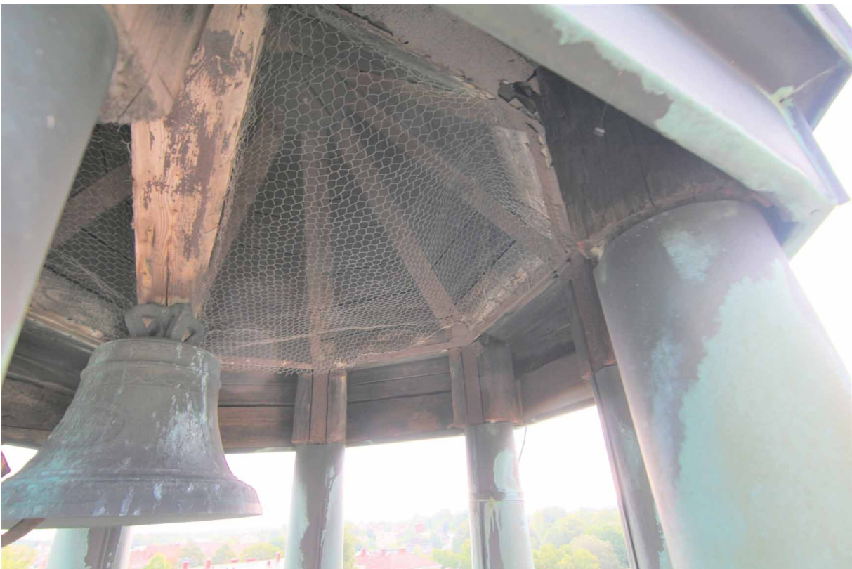
Innertak i lanternin där rostangripen plåt och stålnät ska bytas.
