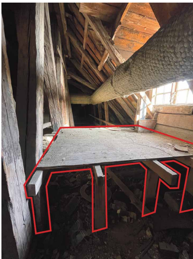
Senida plattform framför takkupa mot söder som är skadad och föreslås demonteras.
