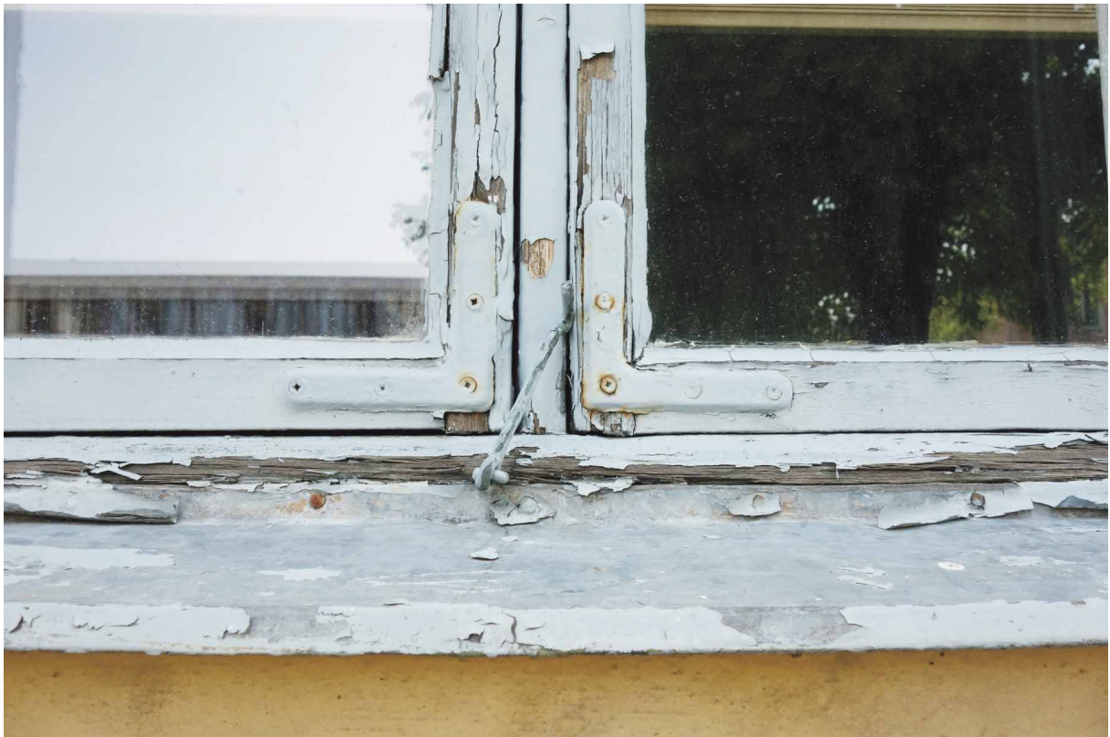
Fönstren i södra fasaden är i sämst skick och här blir träläggningar nödvändiga i framför allt karmbottenstycken.
