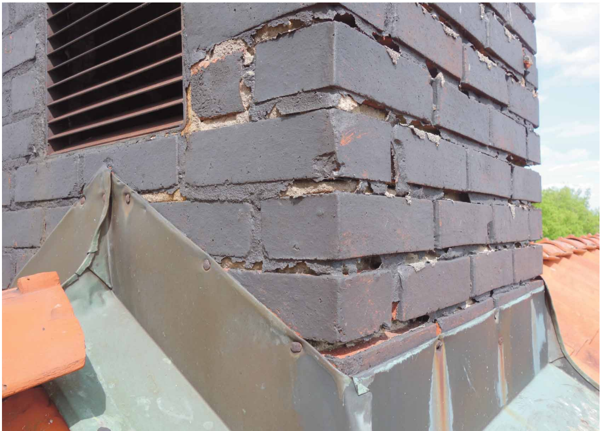
Bristfällig fogning. Målning med modern färgtyp. Notera rosten i anslutningsplåtens infästning.
