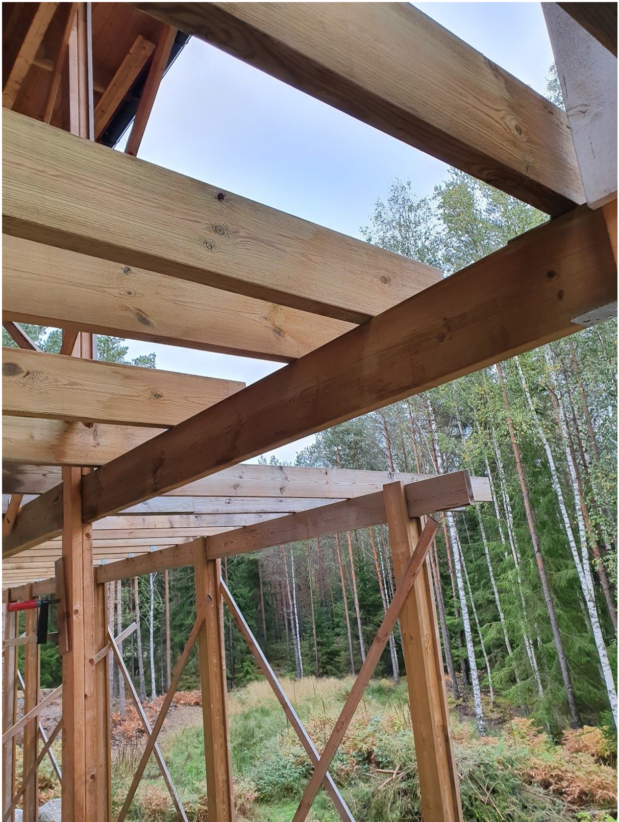
Bilaga 7 / Underredet till altanen som har utgjort del av en byggställning.
