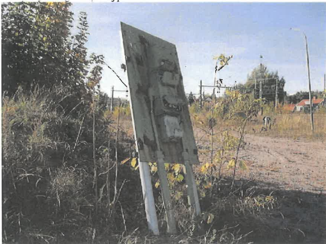
Figur 9 Kopplingstavla för pumpledningar(?) in till depån vid änden av det troliga stickspåret där tankvagnar lossades. Foto: Kristina Ajaxsson, Nyköping kommun (2005).
