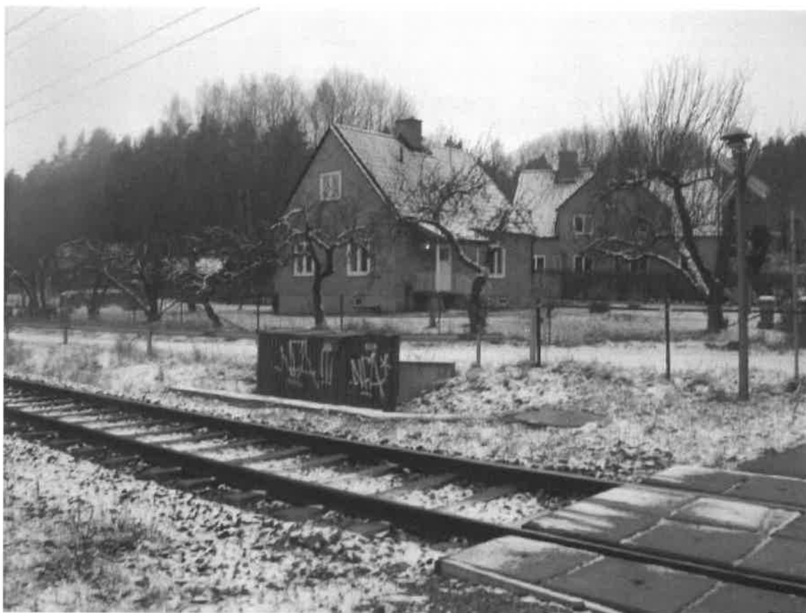
Figur 10 50 Hz hjälptransformator framför 2 gamla SJ hus belägna norr om spåren inte så långt från det gamla lokstallet. Foto: Anna Ågren 2010-12-09.
